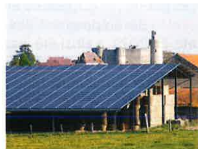
Stabulation équipée de panneaux photovoltaïques à Billy
