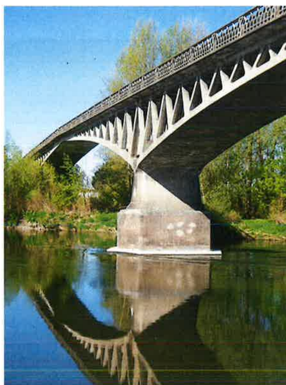
Le pont Boutiron à Vichy, réalisé par Eugène Freyssinet en béton précontraint
